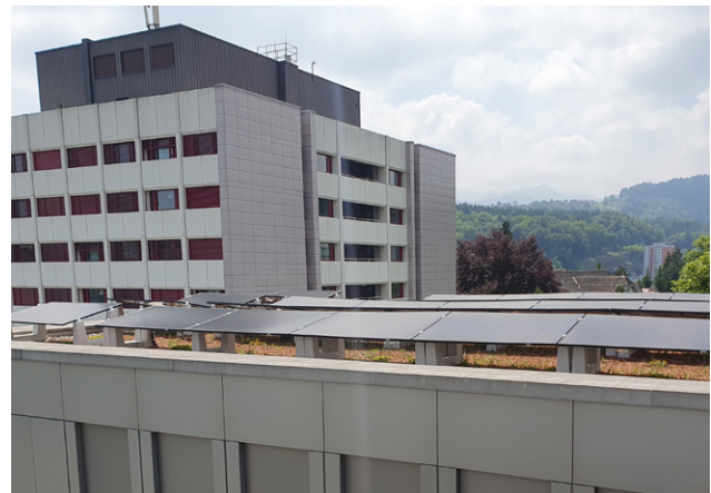
Im Jahr 2023 installierte Photovoltaikanlagen auf dem Dach der Augenklinik (Standort Luzern).
